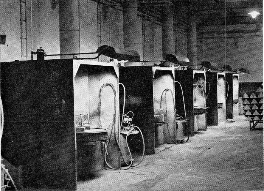
Plaatselijke verlichting in spuitkasten door middel van 4 buislampen TL-40 W in explosie-vrije armaturen.
