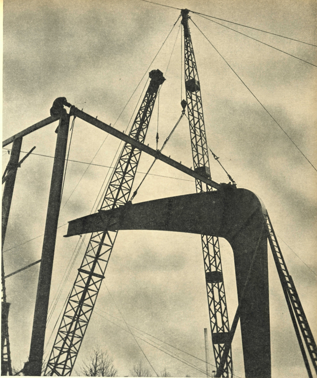
Het plaatsen van deze stalen bogen zal een ieder zich wel herinneren. Het is een opname van de constructie van de nieuwe hal achter het ontspanningsgebouw. Na het jubileum zal zij een gedeelte van de machinefabriek onder haar enorme stalen spanten bergen.
